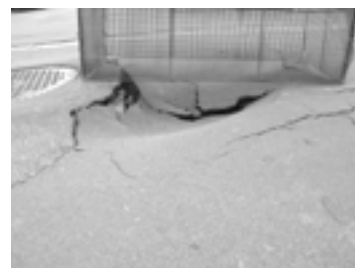
陥没した道路
